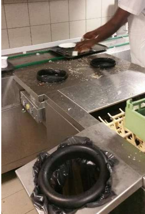
Collecteur installé sous les goulottes de tri :
